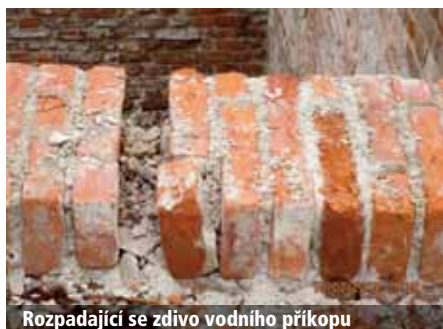
Rozpadající se zdivo vodního příkopu
